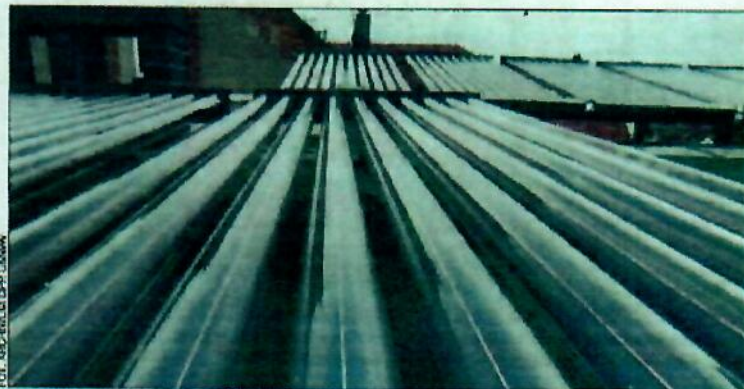
Dzięki wsparciu z WRPO 2007-2013 solary zamontowane m.in. na dachu budynku oddziału chirurgii ogólnej szpitala w Chodzieży.
